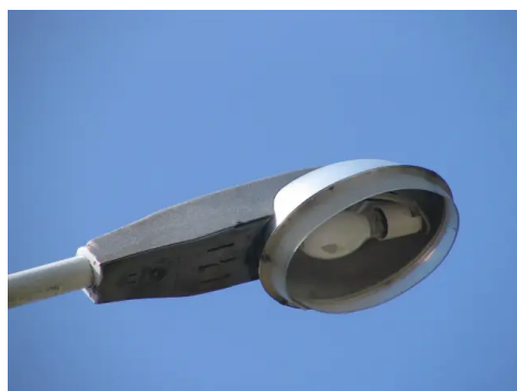
Punti luce stradali preesistenti
