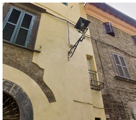
Nuovo impianto - Lanterne a LED
